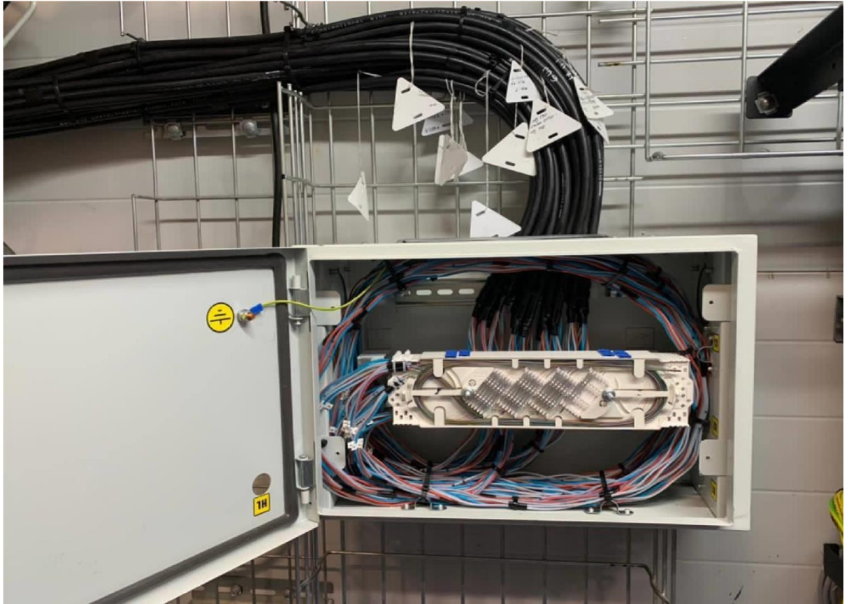
Рисунок 4.3 – Шкаф настенный распределительный, в который входит кабельная продукция
